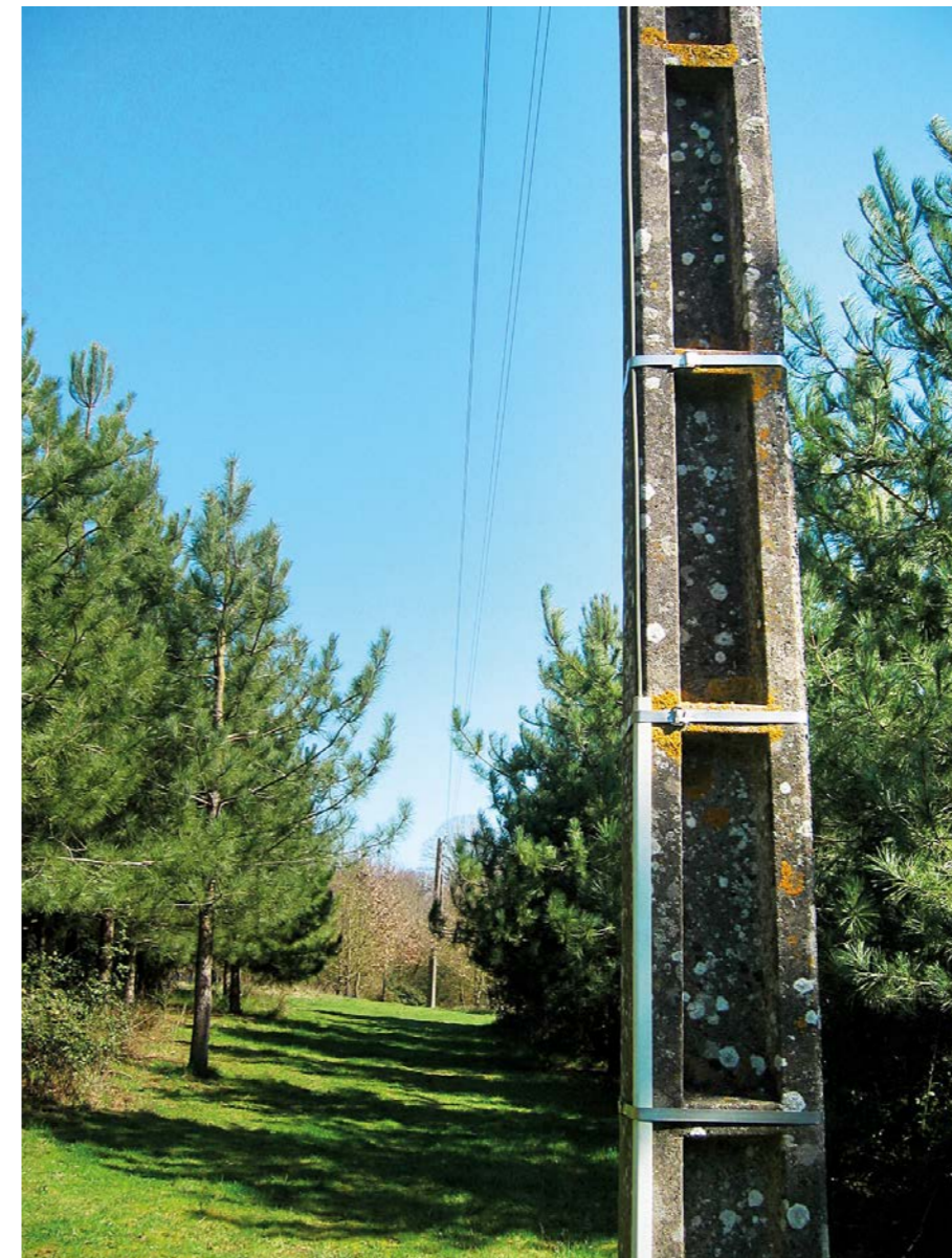
La distance de sécurité à respecter varie selon la puissance de la ligne électrique.
